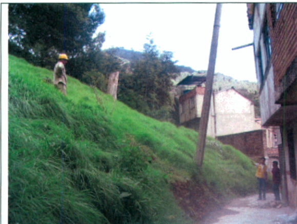
Fotografías 7. Pérdida de verticalidad en un poste por causa de los movimientos lentos de los rellenos antrópicos heterogéneos identificados.
